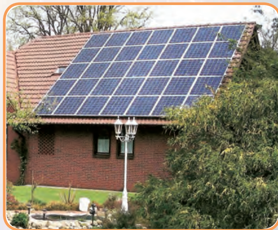
Рисунок 118 – Солнечные панели, установленные на крыше здания
