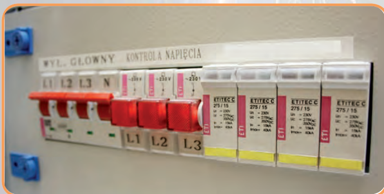
Рисунок 81 – Ограничители перенапряжения ETITECC С по схеме 4+0, смонтированные в распределительном щитке жилого помещения
